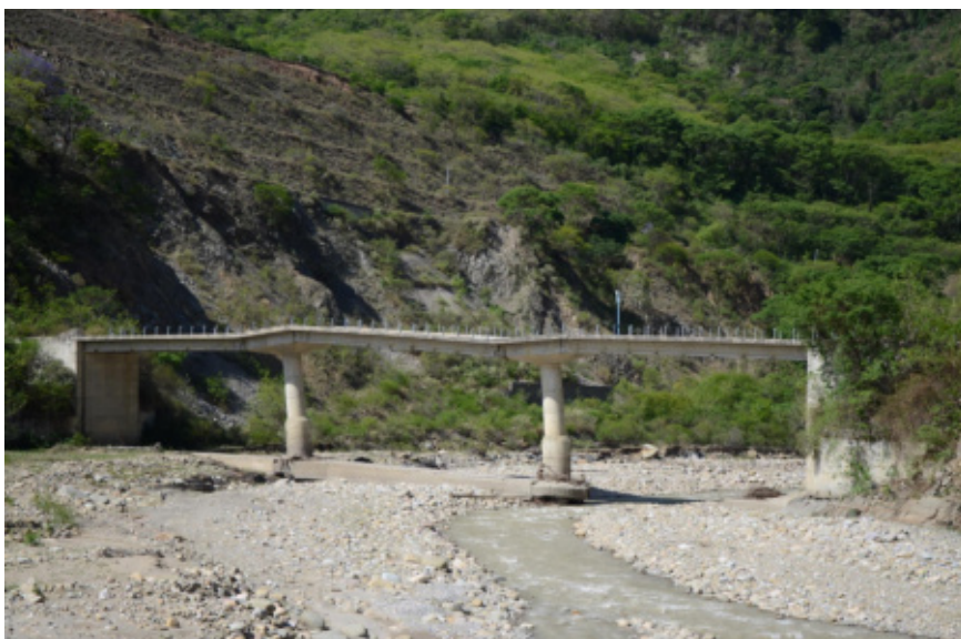
Figura 7. Puente Internacional Mamora-Condado sobre el cauce del río Bermejo, acceso a Los Toldos, actualmente en ruinas.
