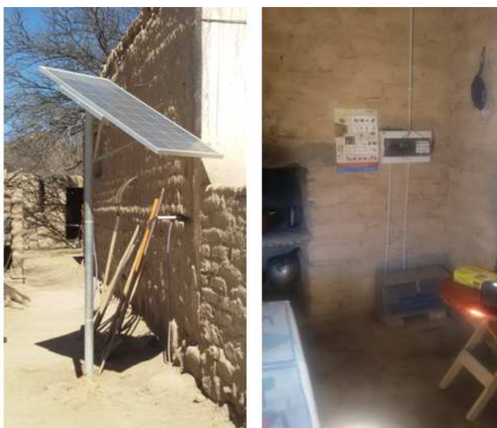
Figura 1. Fotografía de instalación PERMER en la provincia de Catamarca. Fuente: Ministerio de Servicios Públicos, año 2017
