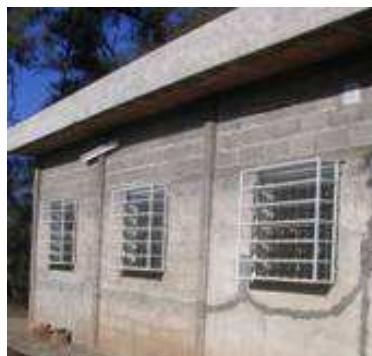
Foto 5.- Ubicación de los estantes de luz en ventanas de la fachada norte.
