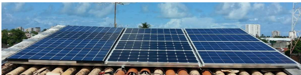
Fig. 1 - SFCR instalado no telhado de um escritório comercial com 1,6kWp potência total.
