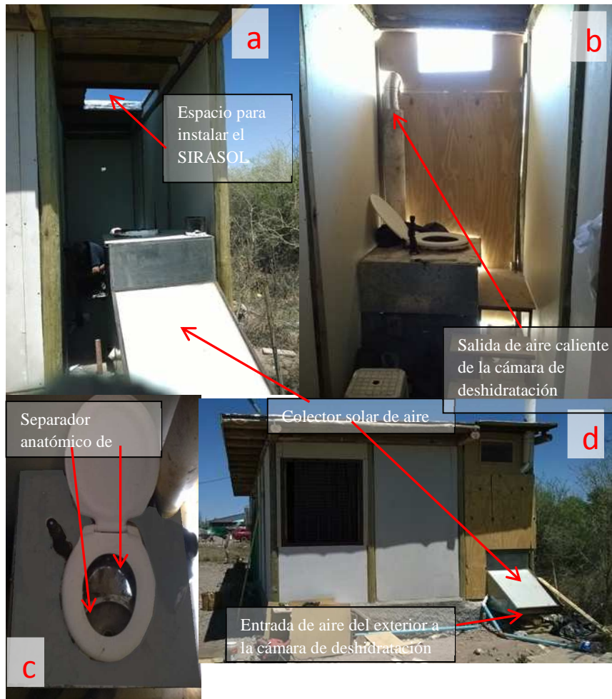
Figura 8: tecnología utilizada en el baño: a) sistema de inodoro solar seco; b) inodoro desde el interior con escalera de acceso; c) taza anatómica con separación de sólidos y líquidos; d) vista de fachada N por el exterior con colector solar del inodoro solar seco.
