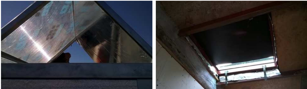
Figura 7: SIRASOL en baño a) durante la instalación por el exterior; b) desde el interior se observa la chapa negra calefactora y la abertura para ingreso de iluminación natural.
