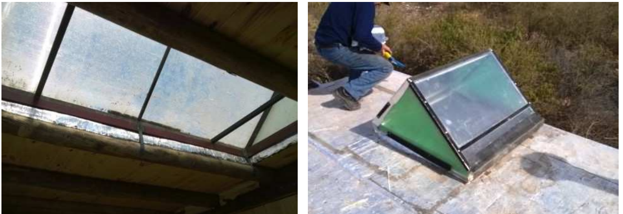
Figura 6: sistema SIRASOL a) del comedor desde el interior; b) del baño desde el exterior
