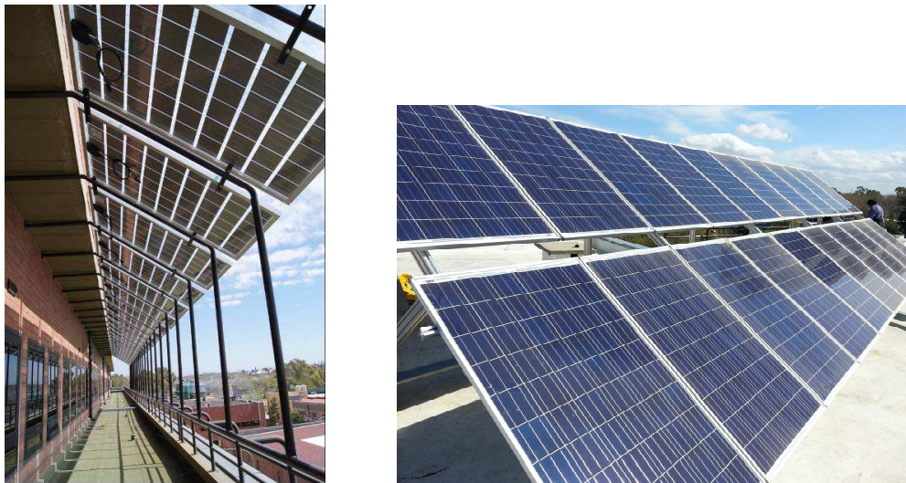
Figura 6.: Sistemas FV instalados en el edificio TANDAR (CAC):(i) pérgola FV con 23 módulos de 215 W p , ubicada en el tercer piso del edificio (izquierda); (ii) 20 módulos FV de 240 W p , ubicados en la terraza (derecha).
