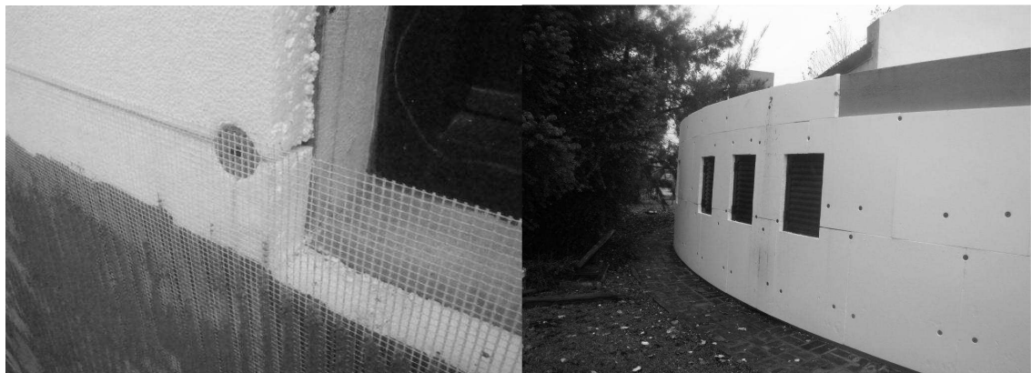
Figura 4: Detalle de malla de fibra de vidrio con base coat. Figura 5: Colocación de EPS en la cara este
