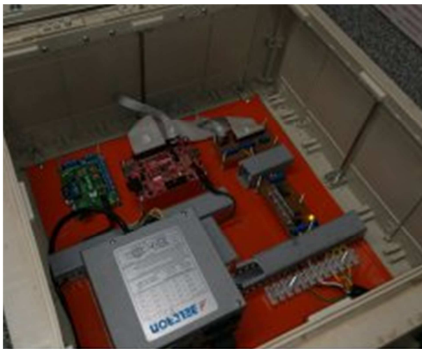
Figura 8: tablero de control de espejo
