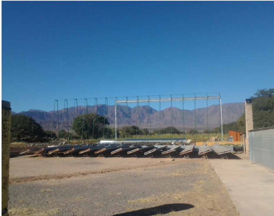
Figura 2: Instalación del generador de vapor basada en concentradores solares de Fresnel
