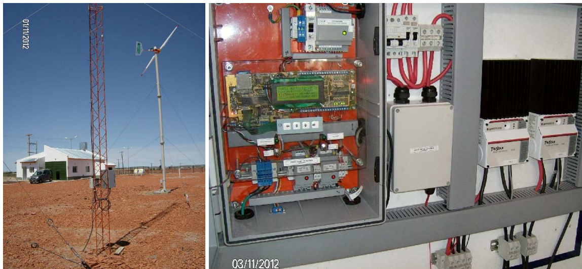
Figura 3 Equipamiento en Campo de Pruebas INTI - Cutral C6 - Máquina INVAP IVS4500, torre de METEONOmad2, PWRC2/48V con sensor de 150A y dos reguladores TS60
