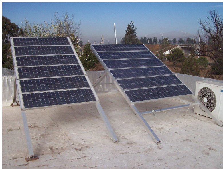
Figura 2: Configuración de la MCFVCR para el año 2012 con un total de 12 paneles fotovoltaicos.
