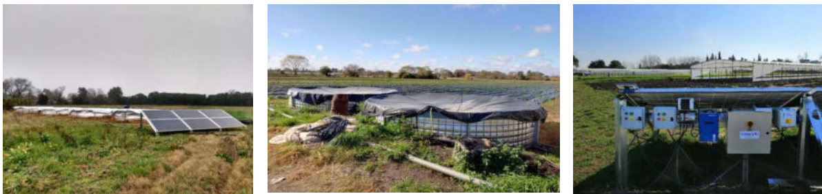
Figura 4: sistema de reservorios y bombeo solar instalado en la localidad de Florencio Varela. A la izquierda se observan los 6 paneles solares que alimentan a la bomba sumergible. En medio los reservorios conectados entre sí. A la derecha la vista general del sistema eléctrico, paneles solares y control de bomba solar. De fondo los invernaderos para la producción hortícola y a campo. Fuente: Elaboración propia.
