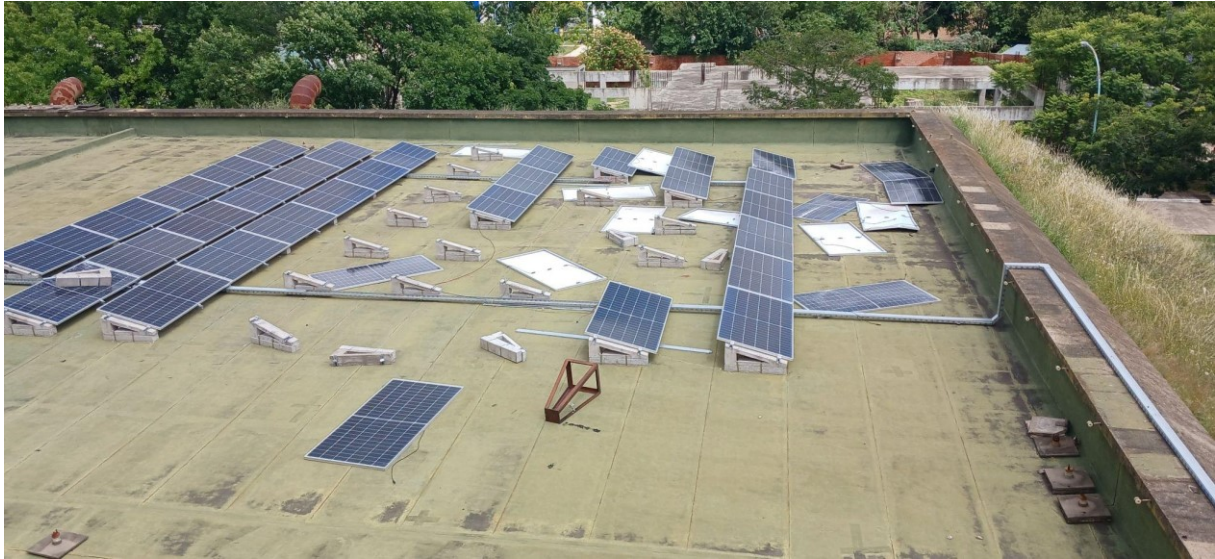
Figura 4. Estado del ala oeste del sistema de 50 kW (Edificio 42, CAC) consecuencia del temporal del día 17/12/2023.
