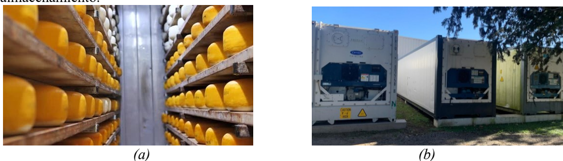
Figura 5: Cámaras de almacenamiento producto final, (a) Interior, (b) Exterior.
