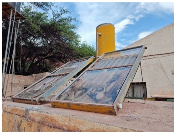
Figura 10: calefones solares deteriorados.
