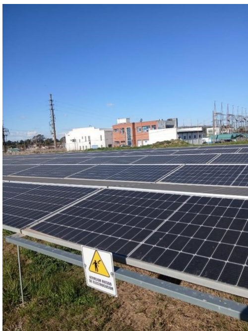
Figura 2: Planta solar fotovoltaica del proyecto Comunidades Solares I, de la Usina Popular y Municipal de Tandil. Imagen propia.
