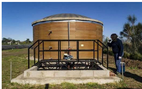
Figura 1. Biodigestor instalado en Los Pinos
