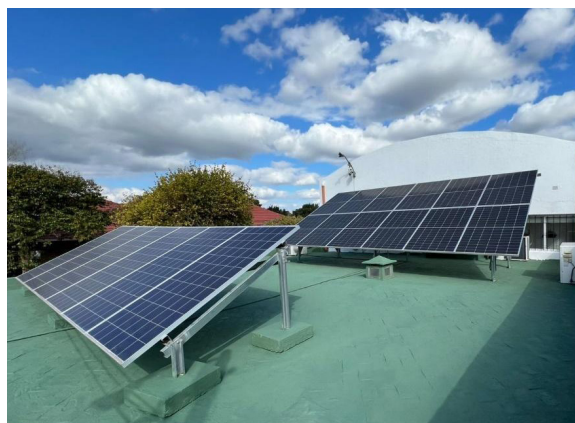
Figura 2. Planta fotovoltaica de la Cooperativa de Ibarlucea
