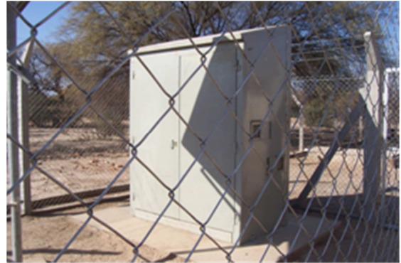
Fig. 10: Vista de un gabinete compartimentado.
