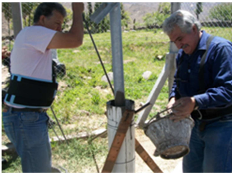
Fig. 9: Bridas metálicas para reparación de columnas de estructura soporte de módulos FV.
