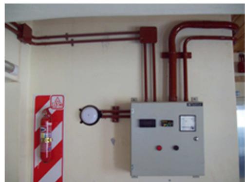
Fig. 12: Vista de un Tablero Principal con campanilla
