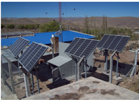
Fig. 2: Vista de Instalación Fotovoltaica en Escuela N° 345 La Hoyada – Dpto. Santa María.
