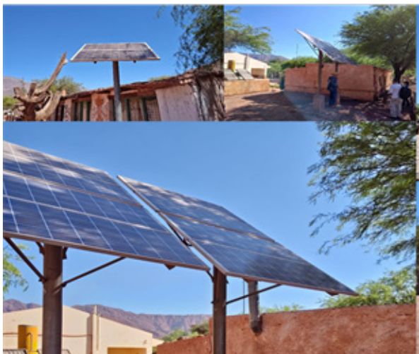
Fig 8: paneles solares fotovoltaicos cubiertos por árboles o capas gruesas de tierra
