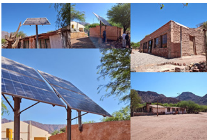
Figura N° 8: paneles solares fotovoltaicos cubiertos por árboles o capas gruesas de tierra
