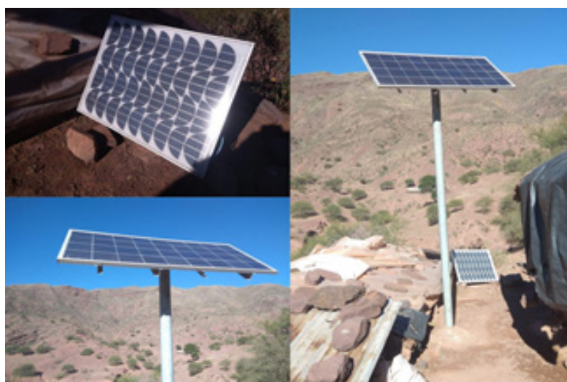
Figura N° 1: Paneles solares PERMER y municipales.
